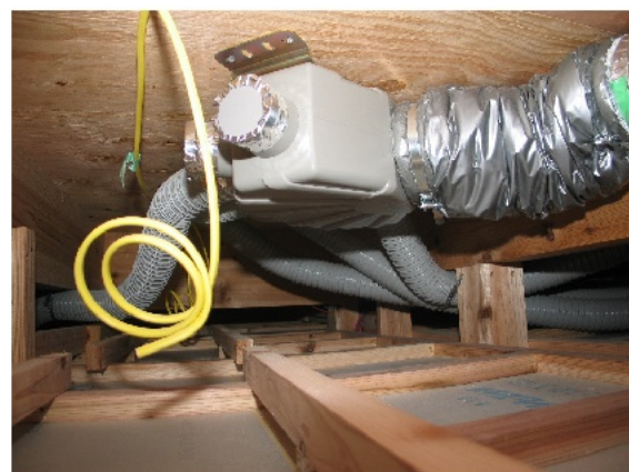
建ててからでは知ること見ることのできない部分を見ていただきました。24時間換気システムです。
